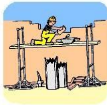
Fig. 11: Falta de orden y limpieza
